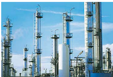
Рис. 20. Ректификационные колонны на нефтеперерабатывающем заводе
